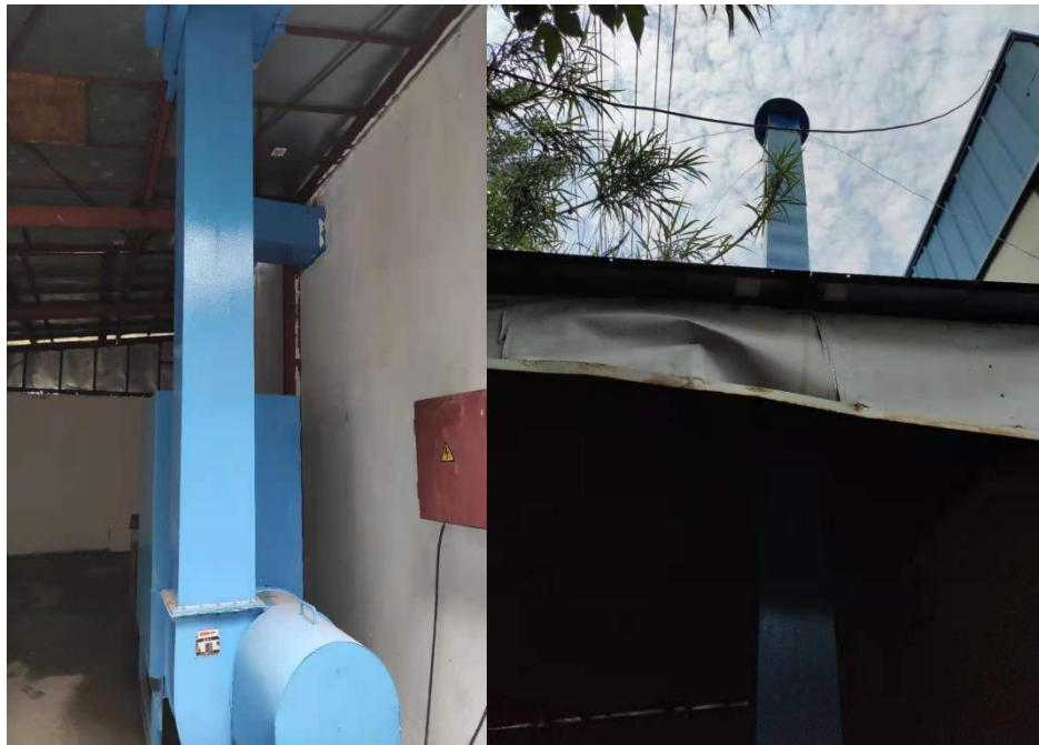
图 3.6-1 危废仓库的处理设施
